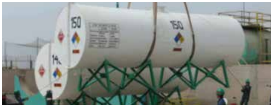
Tanques de Almacenamiento de Combustible, Capacidad 10,000 Gln
