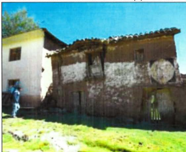
FOTO 26. VIVIENDA AFECTADA POR EL SISMO DEL 6/6/15 PAPRES – PIRQUE
